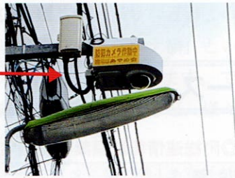
防犯カメラの設置
