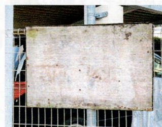
掲示板修繕前
